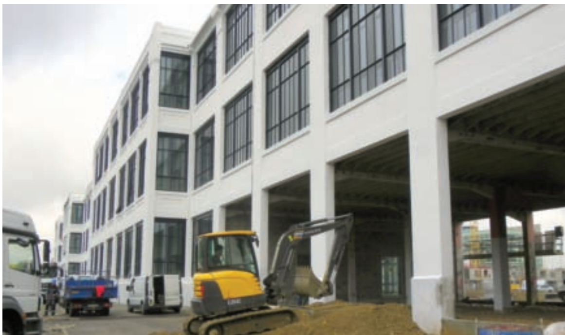
Le bâtiment de façade de l'usine en cours de rénovation, avenue Bataillon-Carmagnole-Liberté.
